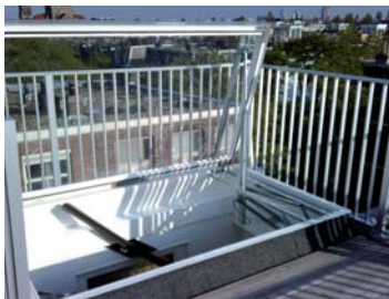
Dachausstieg, mit elektrischer Bedienung
